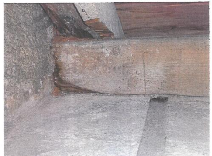
Fäulnisschaden an der Fußpfette und dem Sparrenfuß
