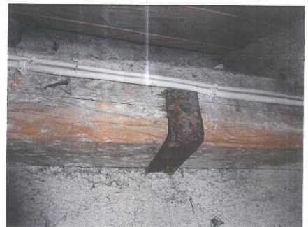
: Korrosion an der Schlauder der Firspfette
